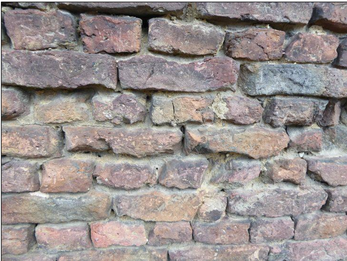
Abbildung 28: Blick auf die bereits poröse Backsteinmauer innerhalb der Scheune.
