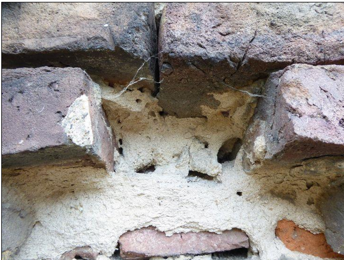
Abbildung 29: Detailansicht auf Löcher in der Backsteinwand.
