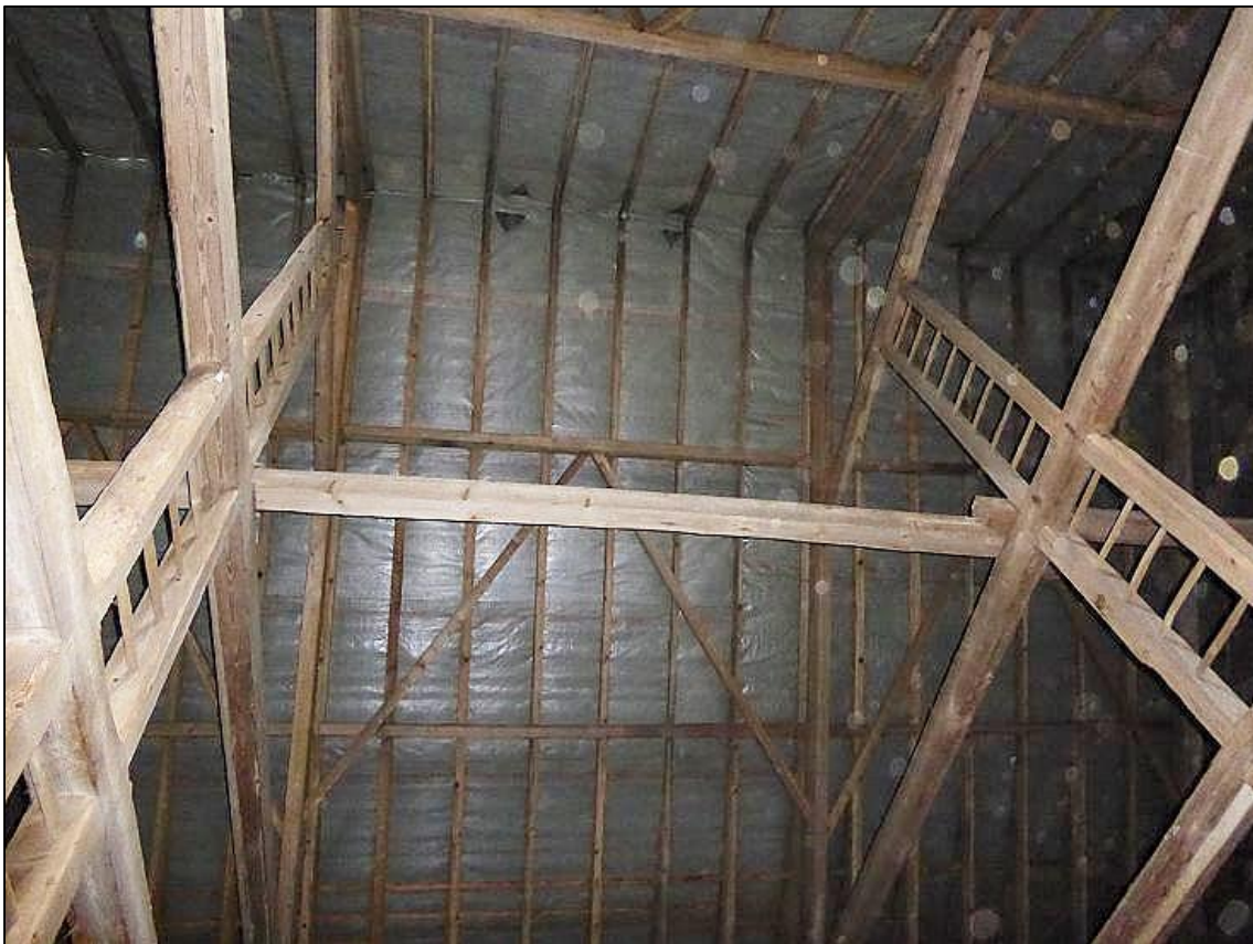
Abbildung 18: Das Scheunendach ist von innen teils mit Unterlegbahn abgedichtet.
