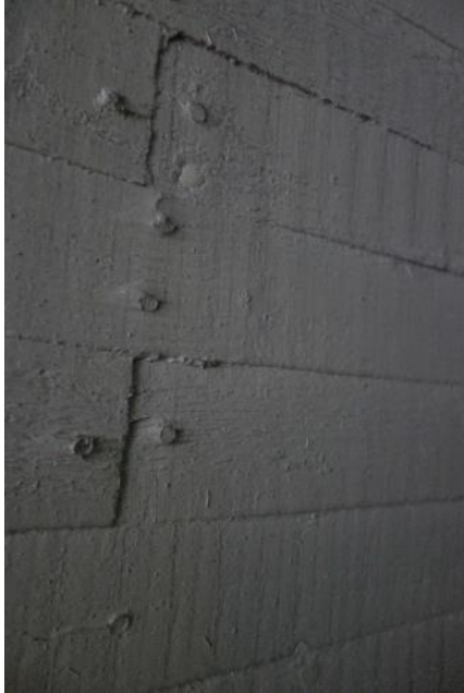
Detail des sichtbaren Schalbrettmusters mit Nagelköpfen, Foto; NF, LVR-ADR, 2022.
