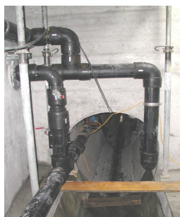
Abb. 5: Vor- und Rücklaufleitungen des WT in Binningen
